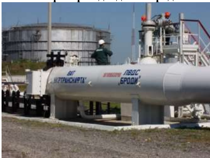
Іл. 11. Нафтоперекачувальна станція (Одеса - Броди)
